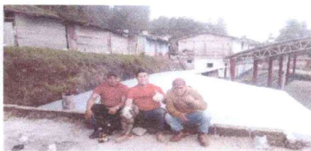
Foto 3: Teecho de la cocina ya terminado donde el agua se filtraba en la lamina en todo el invierno
